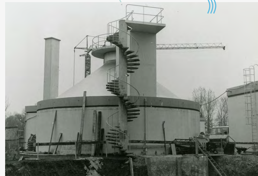
Station d'épuration de Courteille Direction de la communication, 1974 AMA 17F12277
